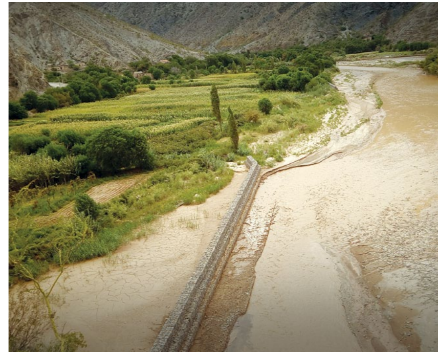
Foto. Defensivo de gaviones que protegerán las parcelas y el sistema de riego de la Comunidad de Atacama frente a las crecidas del Río San Juan del Oro
